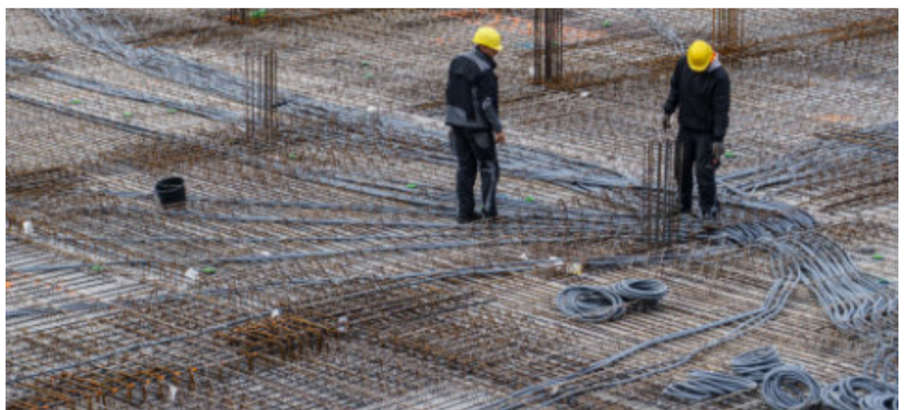
Bild: Leerrohre sorgen für eine schnelle und bedarfsgerechte Nachrüstung der in Zukunft benötigten Ladepunkte
